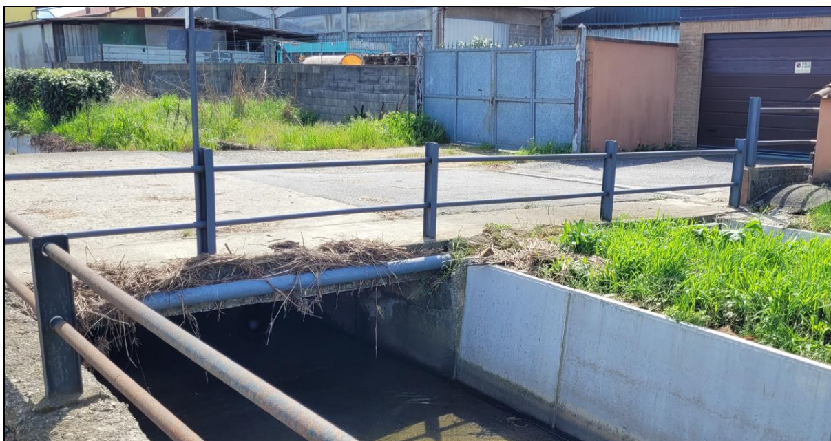
Foto 6 – Via Borghetto a Betlemme: la vegetazione indica l'altezza raggiunta dall'acqua.
