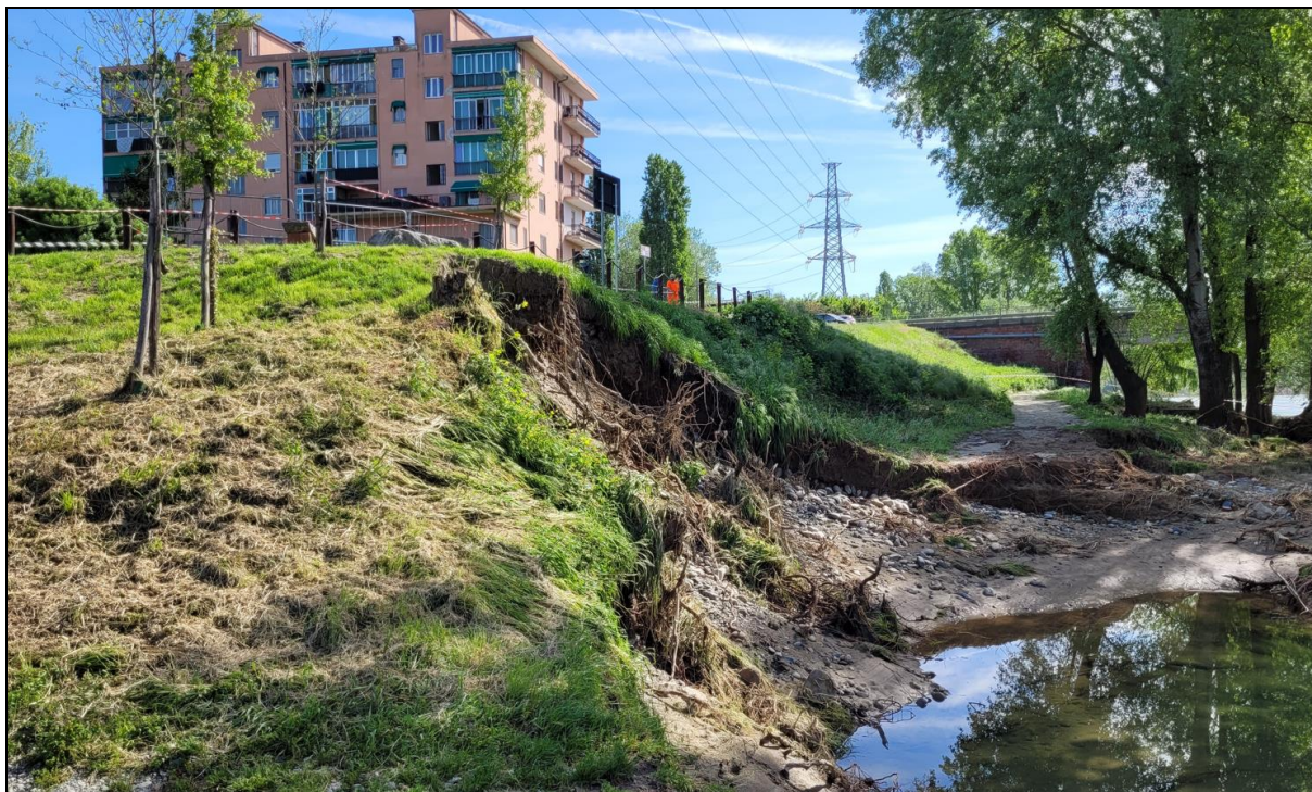
Foto 1 – Erosione del F. Po e accumulo di materiale in fregio alla sponda sinistra presso Via Brozola.
