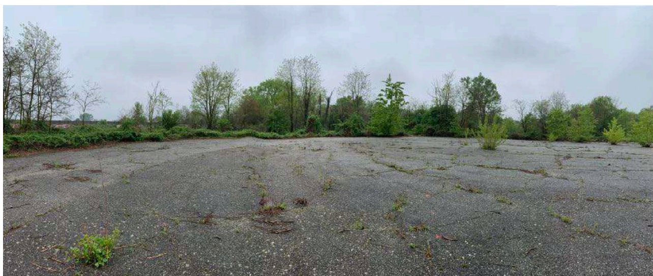
FIGURA 5 FOTO DEL PIAZZALE CON ROTTURE DELLA PAVIMENTAZIONE
