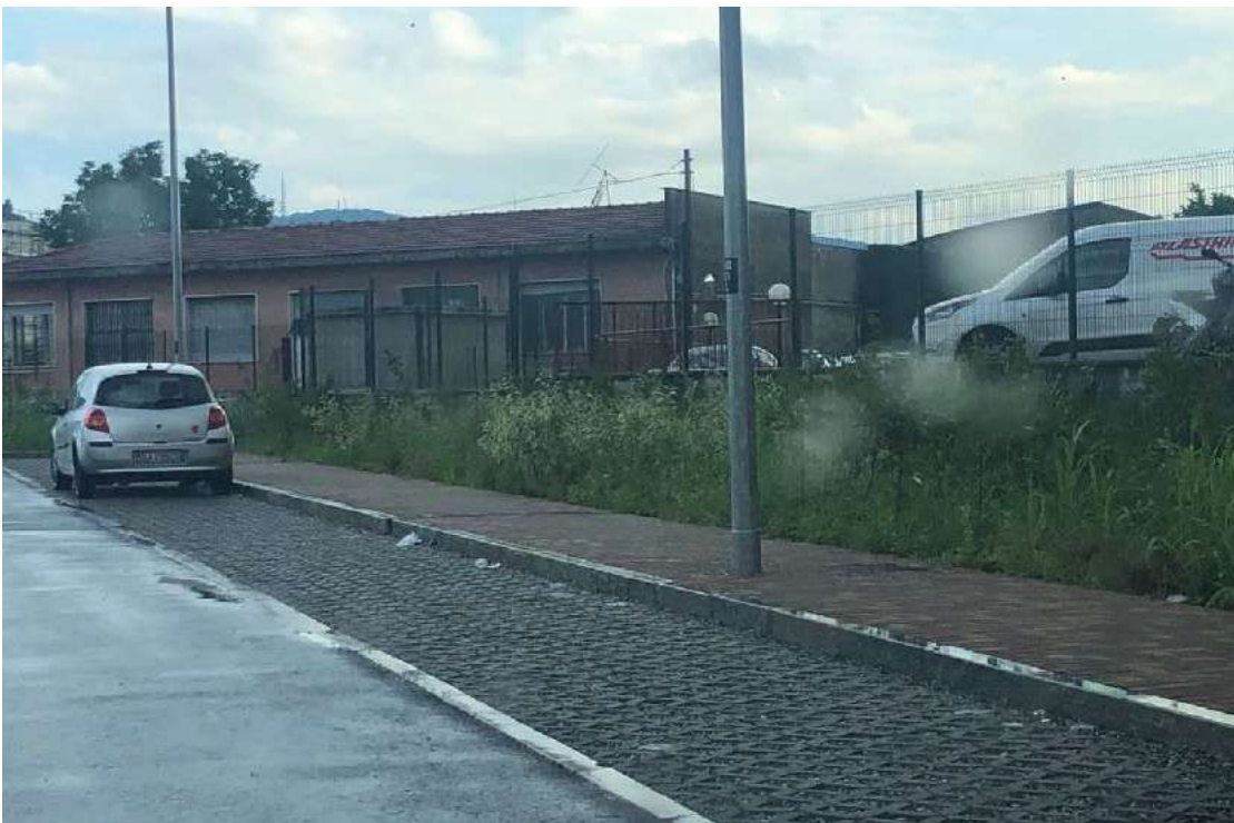
LA STESSA PAVIMENTAZIONE DOPO UN MESE DALLA REALIZZAZIONE FOTO SCATTATA DURANTE UN EVENTO PIOVOSO
