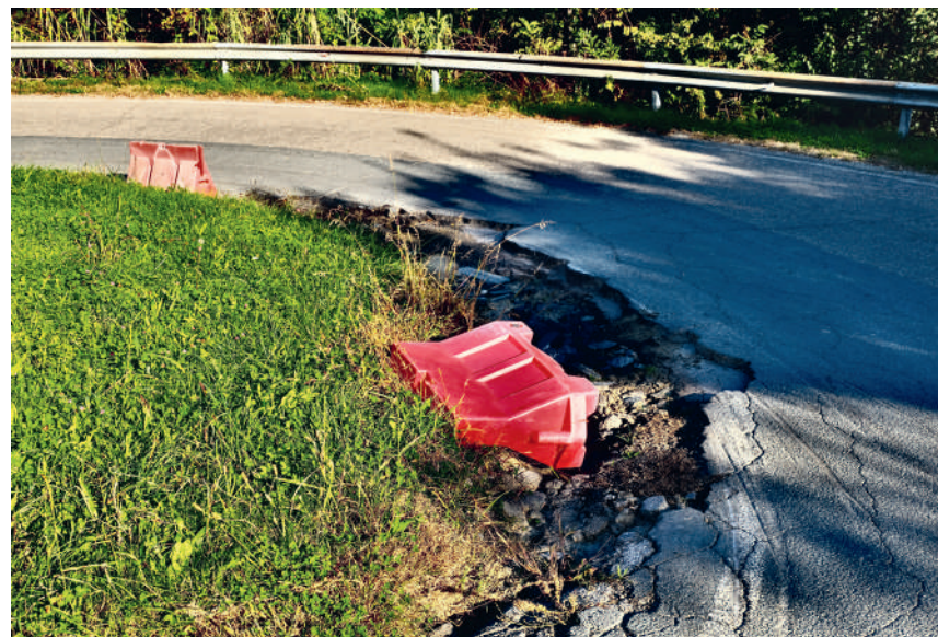
Figura 228: cedimento carreggiata stradale
