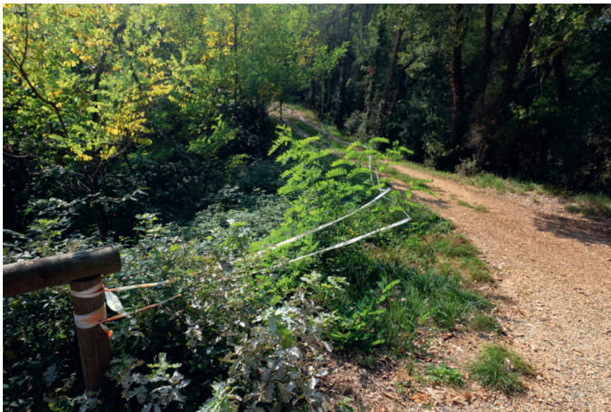
Figura 182: smottamento a bordo di una strada sterrata.
