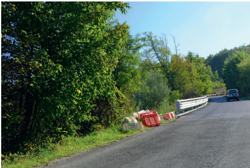
Figura 185: cedimento del manto stradale
