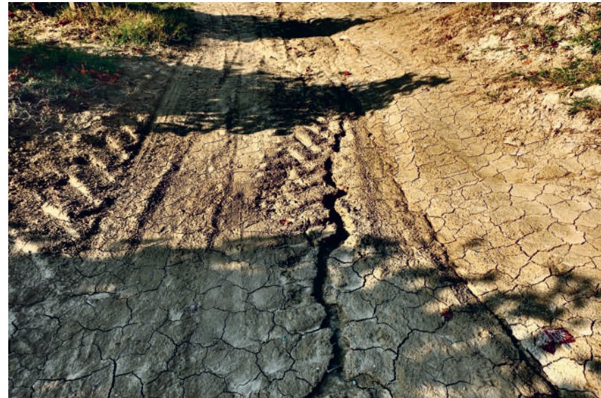
Figura 216: dissesto e compattazione
