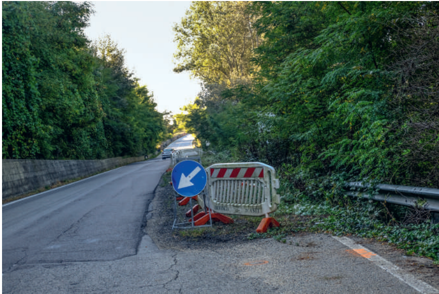
Figura 181: smottamento con cedimento del manto stradale
