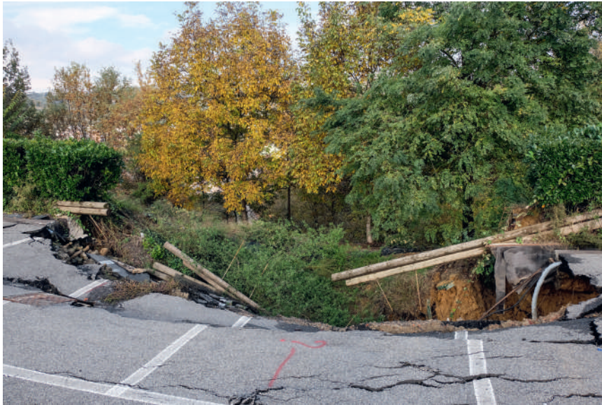
Figura 184: cedimento del manto stradale
